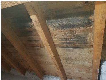
Aufzeichnung von Schäden durch Kondensat
